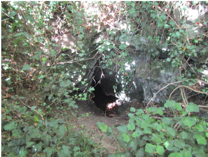
Illustration 6 : Vue sur le vide identifié dans le talus boisé en contrebas du chemin carrossable, au sud de l'entrée actuelle de la carrière
