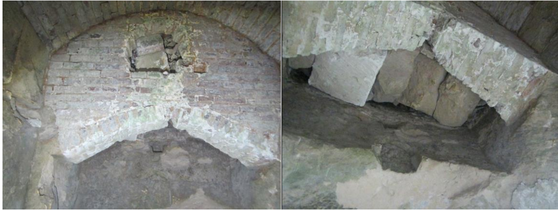
Illustration 12 : Instabilité métrique suspendue au droit de l'entrée
