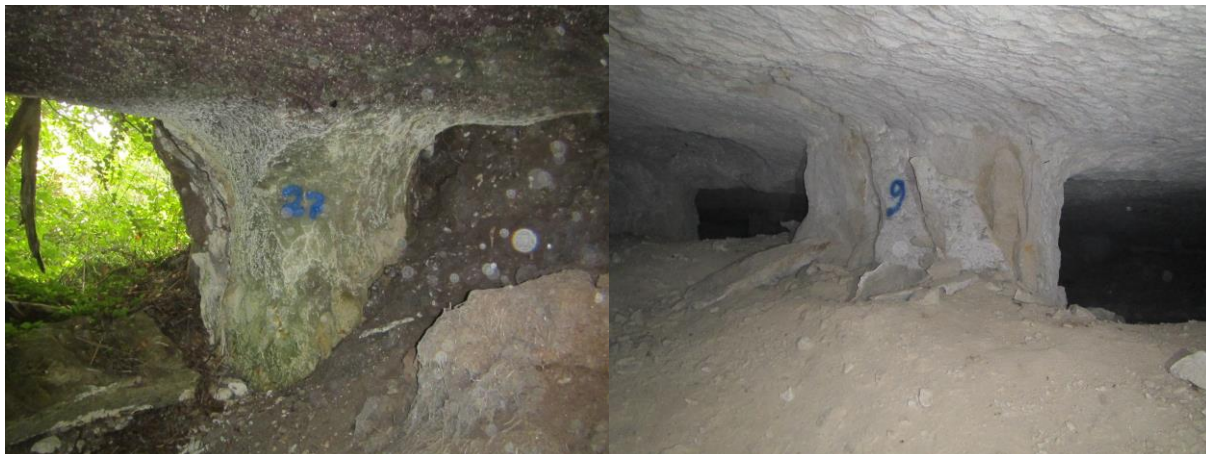
Illustration 9 : Vue sur les deux piliers en mauvais état (P27 à gauche, P9 à droite)
